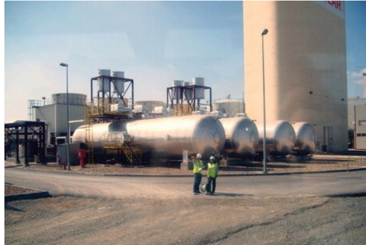
PS 10 Séville: 25 MWh vapeur 40 bars 250°C
