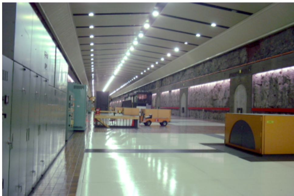
Vue intérieure de la centrale Robert Bourassa
