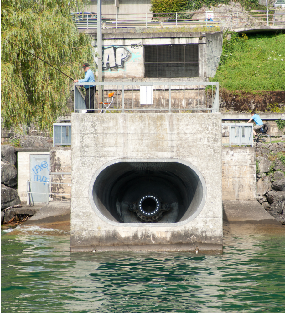
Vanne de fond utilisée pour vidanger un réservoir de ses sédiments
