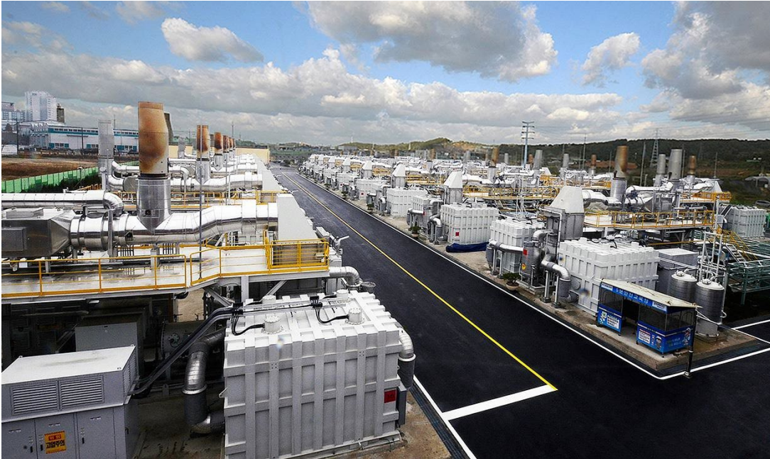
2013 – Centrale de production d'hydrogène et de chaleur avec une capacité de 59 MW GYEONGGI Hydrogen Power Plant – South Korea
