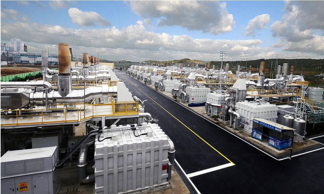
2013 – Centrale de production d'hydrogène et de chaleur avec une capacité de 59 MW GYEONGGI Hydrogen Power Plant – South Korea
