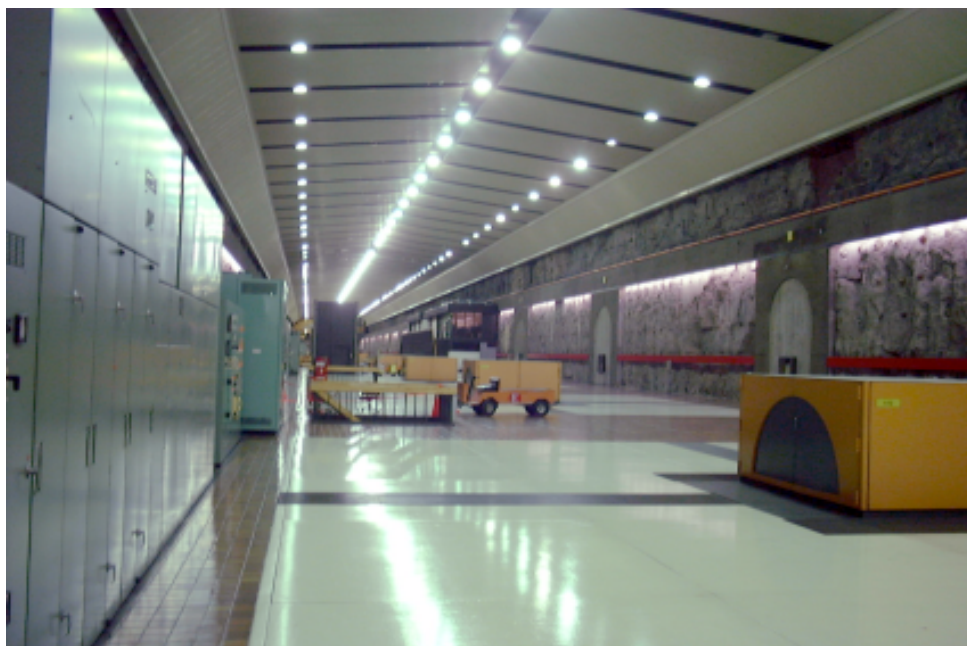
Vue intérieure de la centrale Robert Bourrassa
