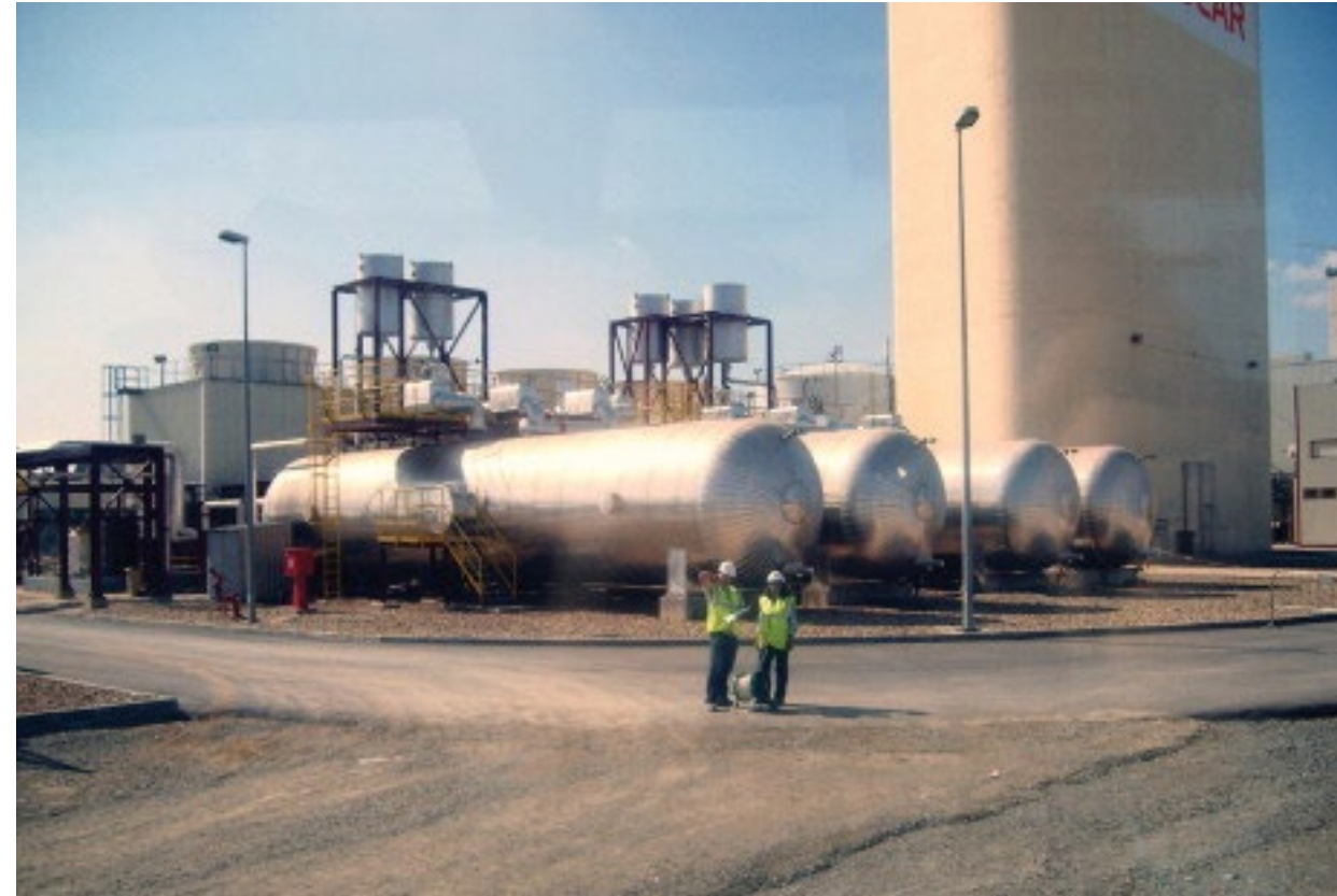
PS 10 Séville: 25 MWh vapeur 40 bars 250°C
